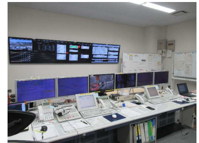
消防指令システム
