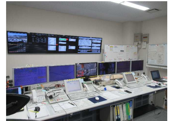
消防指令システム
