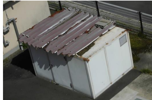
ポンプ室屋根腐食・破損（能義小）
