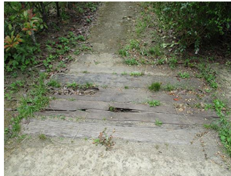
安田団地の敷地内通路 駐車場、敷地内通路及び住戸のエントランスにある枕木が全体的に腐食し、敷地内の至る所に穴が開いている。危険な枕木は撤去し、土又はコンクリートで補修。駐車場については、枕木を撤去し、舗装する。
