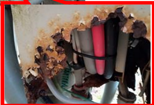
山佐ダム体験交流施設 開閉器盤底部腐食状況
