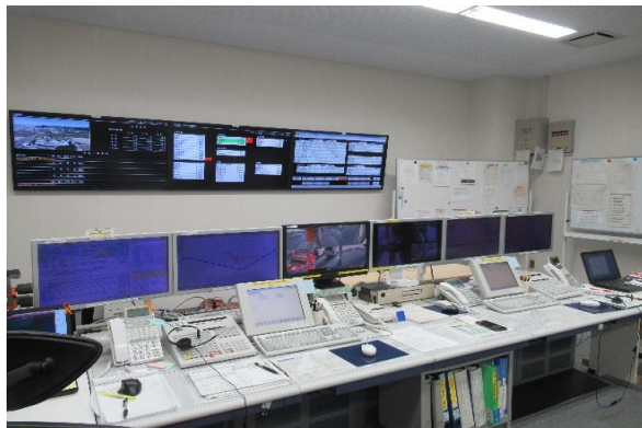
消防本部 通信指令システム
