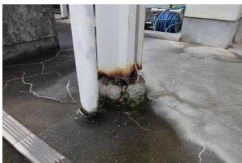
屋内運動場玄関柱の腐食（井尻小）
