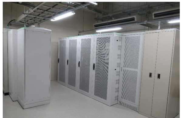
消防本部 機械室
