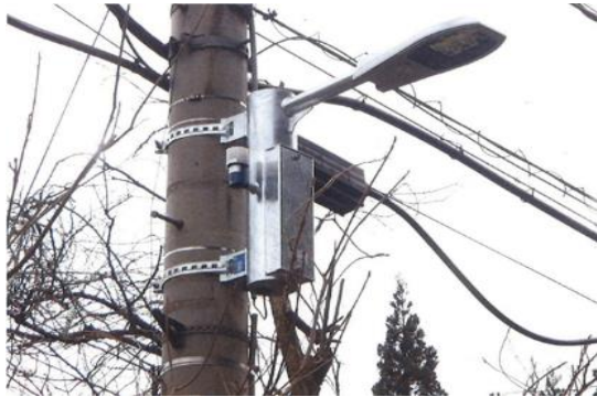
交通安全対策 (照明灯のLED化)
