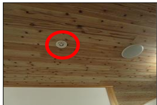
安来節演芸館非常灯不点灯（1階）
