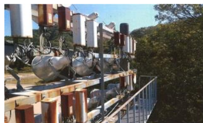
照明安定器の腐食
