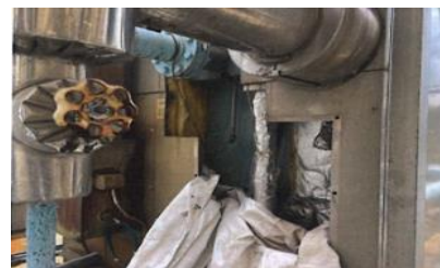
空調設備内部で発生した水漏れ
