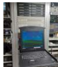
安来センター局舎機器
