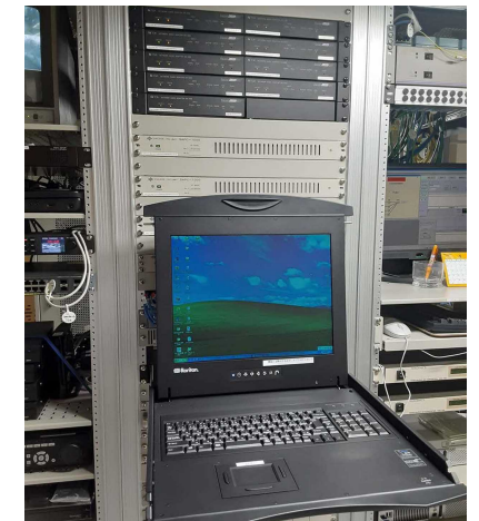
安来センター局舎機器
