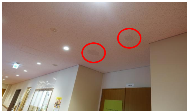
(工事請負費) 2階空調設備配管改修工事(配管結露滴下により浸出し)
