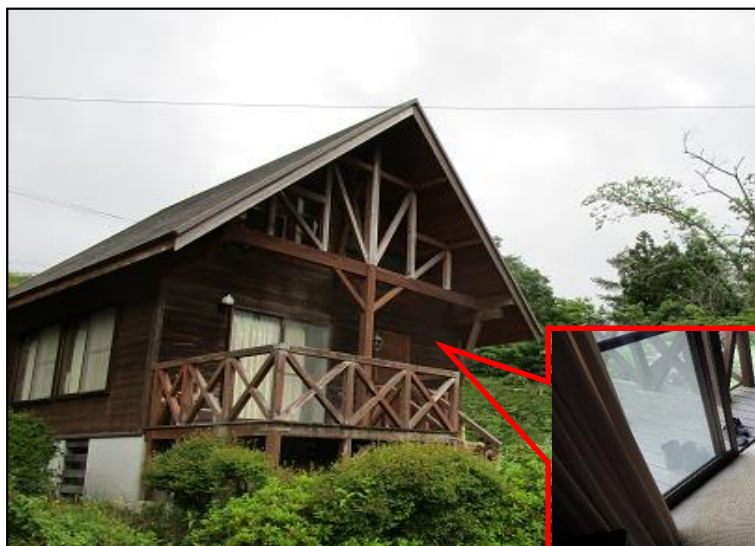
山佐ダムコテージ室内老朽化状況
