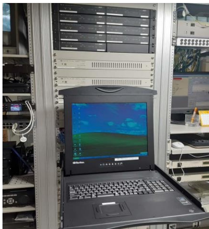
安来センター局舎機器
