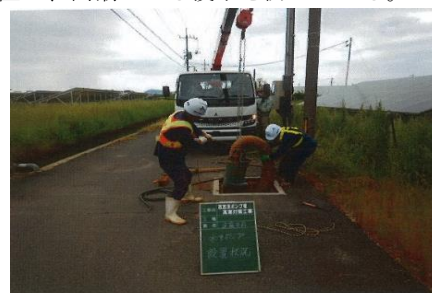
ポンプ設置状況
