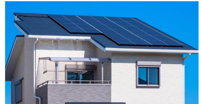
太陽光パネル
