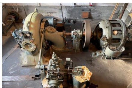
布部発電所 水車・発電機
