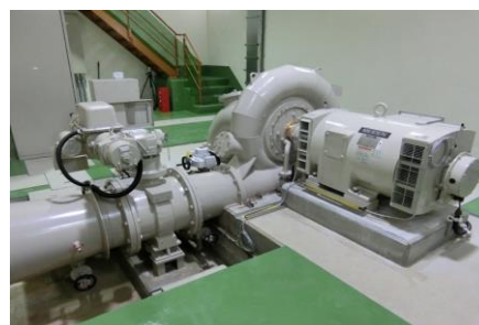
伯太発電所 水車・発電機
