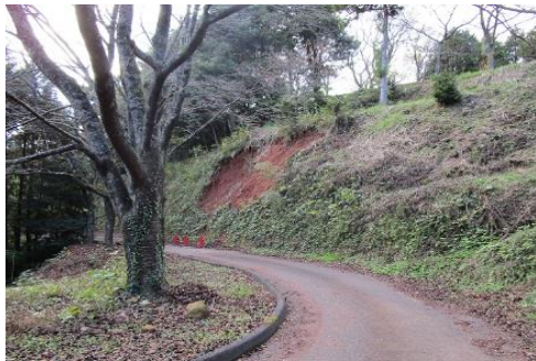
崩落した法面（遠景）
