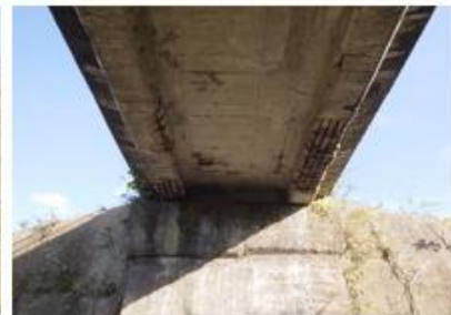
桁・床板部分の鉄筋露出
