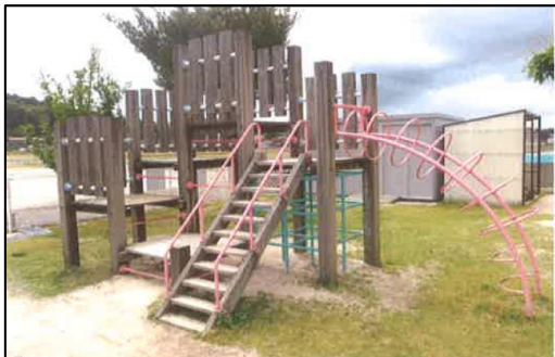
認定こども園大塚 コンビネーション遊具 全体的に老朽化し、危険なため撤去。同園庭内の滑り台を移設する。
