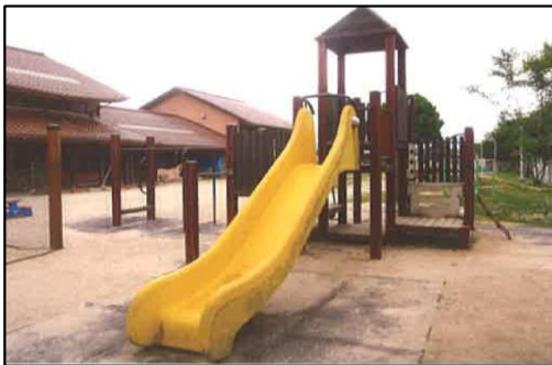
認定こども園安田 コンビネーション遊具 全体的に木材部分の腐食とボルトの錆びが発生。改修し、安全に使用可能な状態にする。
