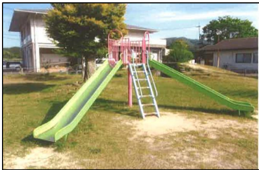
認定こども園飯梨 滑り台 ボルトを始め、全体的に錆びによる腐食。改修し、安全に使用可能な状態にする。
