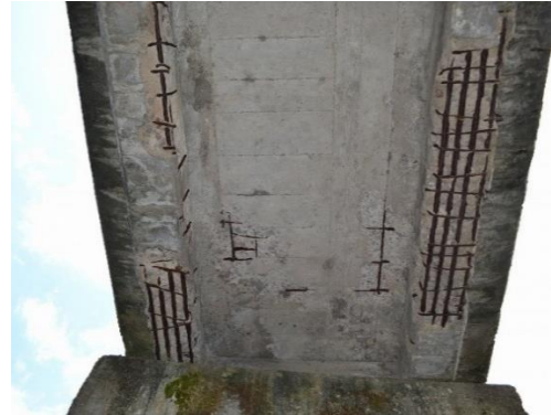
桁・床板部分の鉄筋露出
