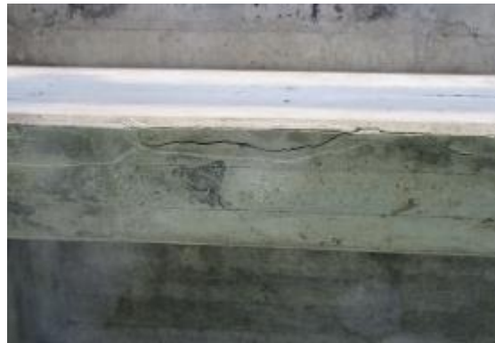
主桁部分の割れ
