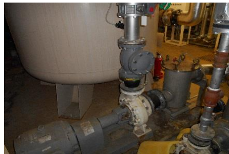
整体浴循環ポンプ
