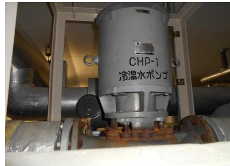
管理棟冷温水ポンプ
