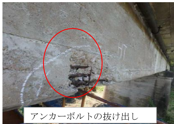
アンカーボルトの抜け出し コンクリート主桁部分の鉄筋露出
