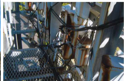
安定器の劣化
