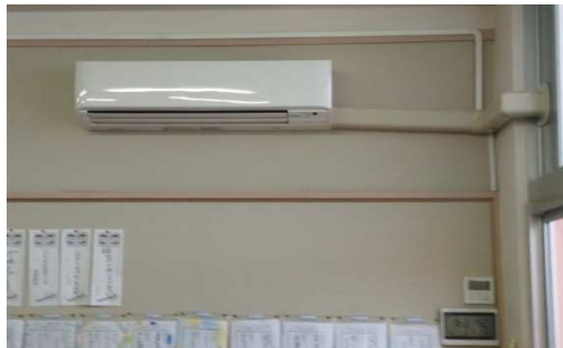
【教室に設置したエアコン】
