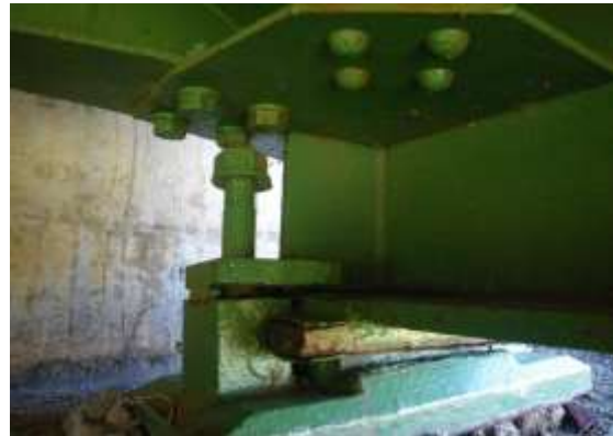
支障部のアンカーボルトの抜け出し
