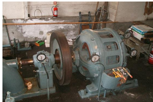
布部発電所 発電機
