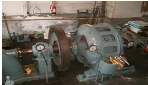
布部発電所 発電機
