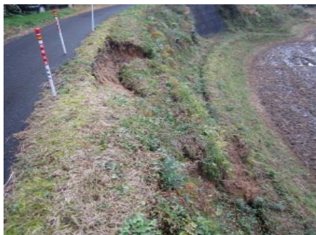
↑ 広瀬町宇波 宇波線被災状況
