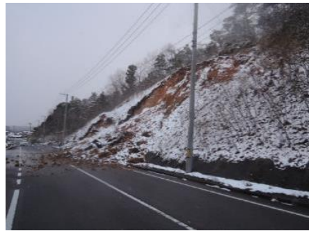
↑ 清瀬町 清瀬神宮寺線被災状況
