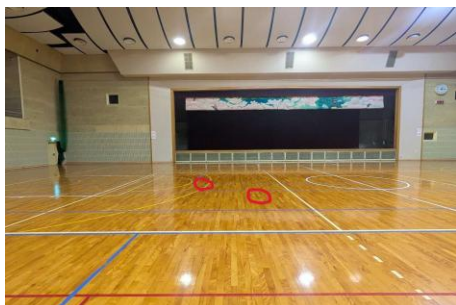
安来市民体育館 雨漏り箇所
