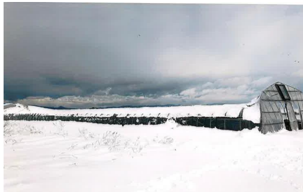
被災状況（外観）
