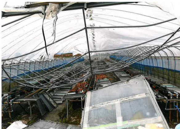
被災状況（内観）
