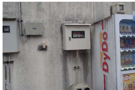
照明制御盤施工後
