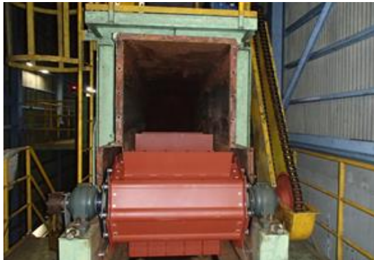
清瀬クリーンセンター受入供給コンベア
