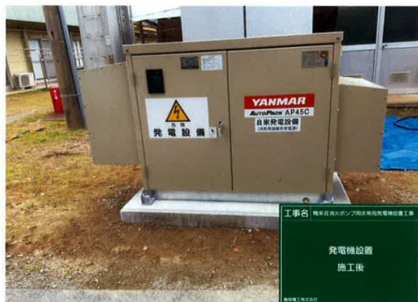
消火ポンプ用非常用発電機
