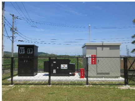
非常用発電機の設置
