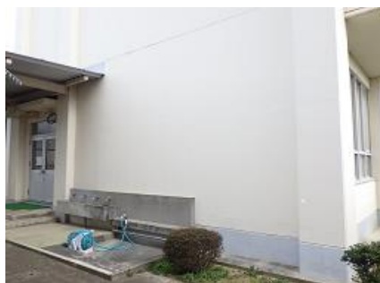
能義小学校エアコン設置工事前（機械・電気）
