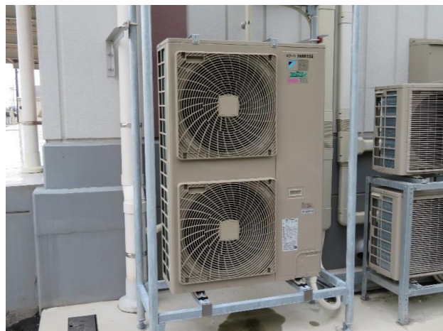
エアコン室外機
