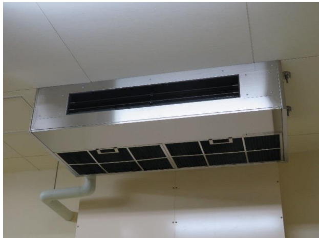
エアコン室内機
