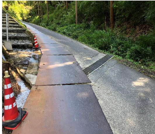
横断溝及び敷鉄板の下にある側溝に土砂が堆積し、閉塞した。
