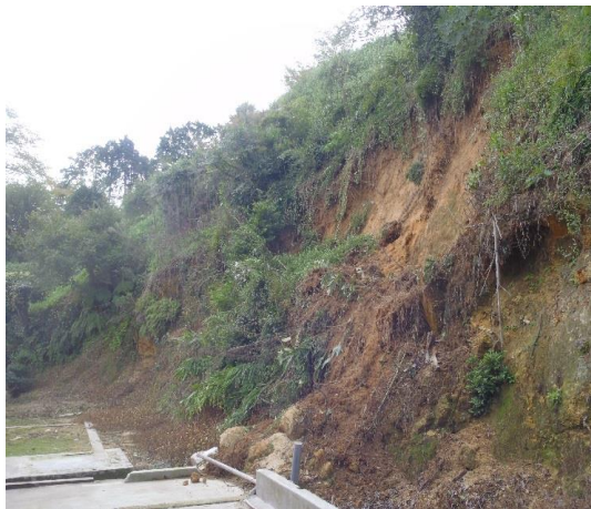
写真左側に民家あり。被災したのが土壘斜面。
