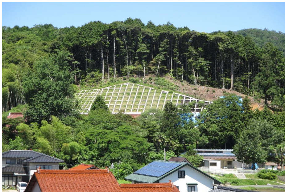
目谷地区急傾斜地崩壊対策事業（宗松寺・旧広瀬幼稚園裏）
