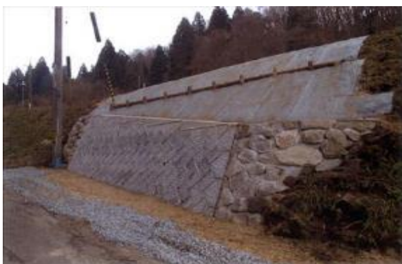
平成29年災3/72山口農地災害復旧工事
