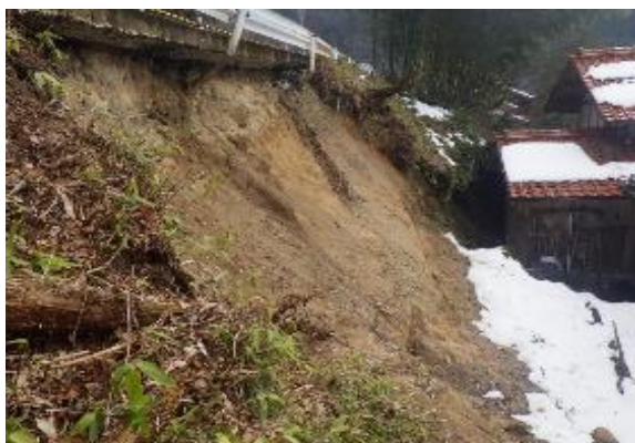
補助災害 下金原線道路災害復旧工事 着手前写真
