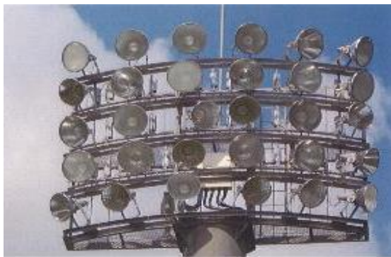
改修後の電灯設備
