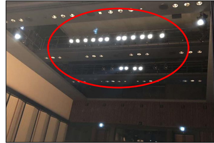
小ホール舞台照明のLED化(1/4期目)
