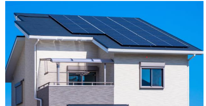
太陽光パネル
