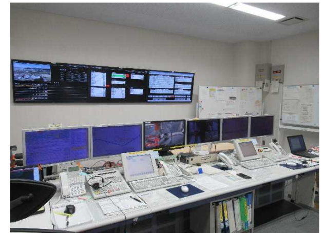
消防指令システム
