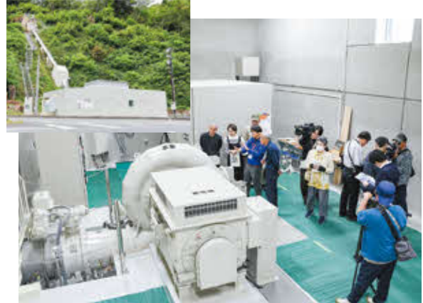
▲発電所の内部。年間発電量は約400世帯分に相当し、約5,200万円の売電収入を見込んでいます。
