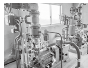
▲水を送るポンプ設備
