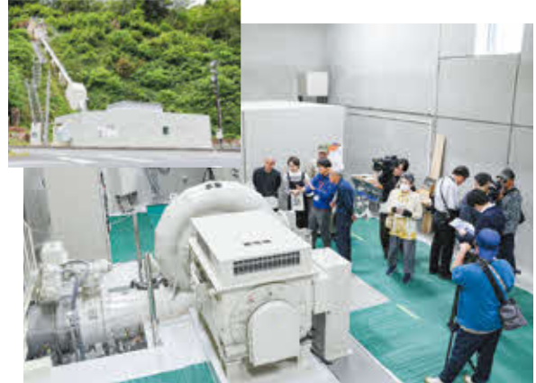
▲発電所の内部。年間発電量は約400世帯分に相当し、約5,200万円の売電収入を見込んでいます。
