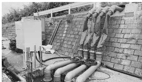
▲東飯島地区の内水対策事業。写真は令和4年7月に設置した仮設ポンプ。
