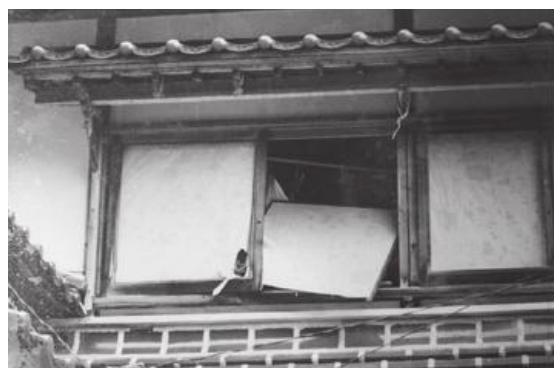
▲破損した2階の雨戸（山尾さん宅）。
