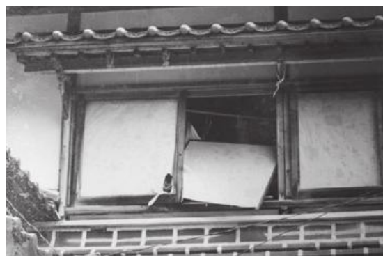
▲破損した2階の雨戸(山尾さん宅)。
