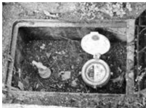
▲止水栓(左側)は水道メーターボックス内にあります。
