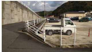
②市道との段差
