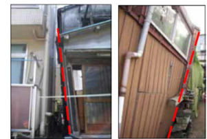
柱の変形が著しく崩壊の危険がある例
