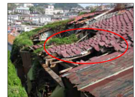
柱、はりの破損や変形が著しく崩壊の危険がある例
