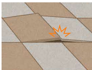
床タイルの浮き
