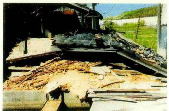
全壊した家屋（安来市）
