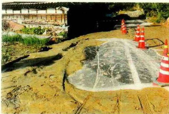
液状化した市道（安来市）
