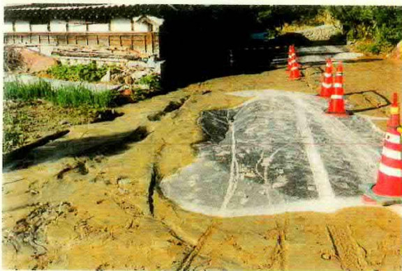
液状化した市道（安来市）
