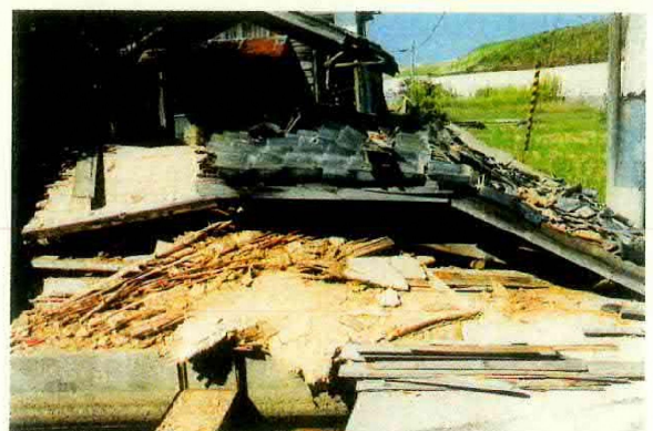
全壊した家屋（安来市）
