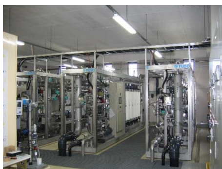
【川平膜ろ過設備（広瀬町）】
