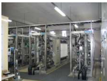
【川平膜ろ過設備（広瀬町）】
