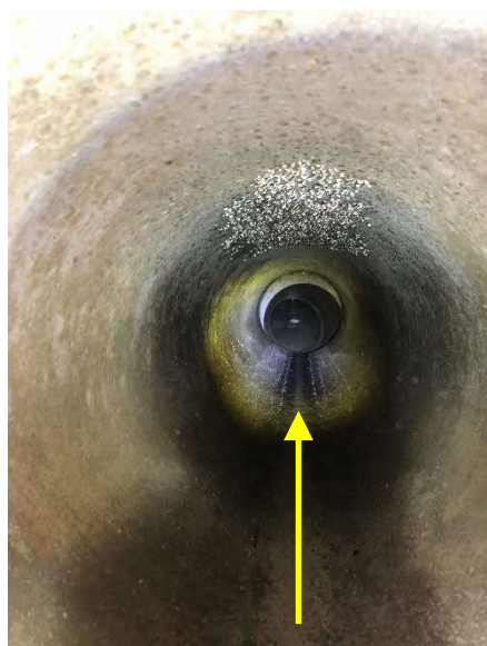
校庭からの排水管
