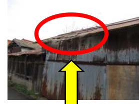
屋根が剥がれて強風の際は飛散する可能性がある
