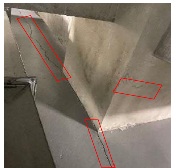
床及び柱のひび割れ
