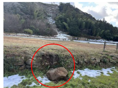
山中御殿平石垣崩落
