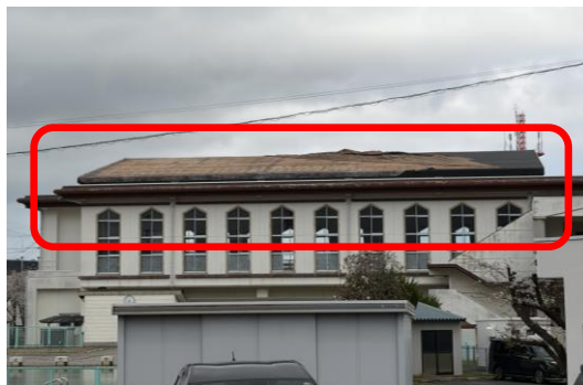
体育館屋根 南面 (防水シートの大半が剥離)
