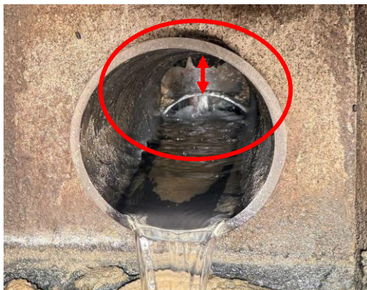
汚水配管のずれ
