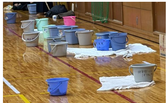
フロア雨漏り状況
