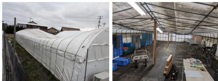
大雪被害状況
