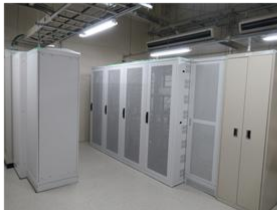
消防本部 機械室
